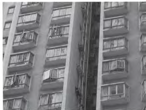
写真 4. 外部から見たアモイガーデンの配管、建物の凹部に注意
