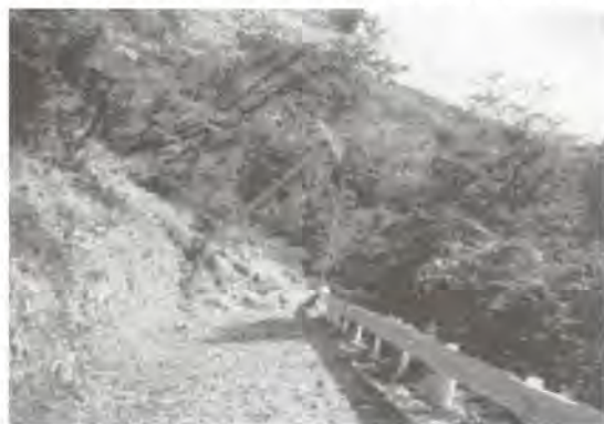
同地震による地盤崩壊
