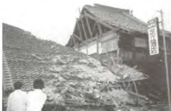
鳥取県西部地震による木造建物の被害
